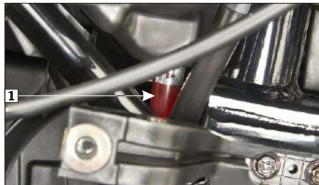
(1) Tubo de drenaje
